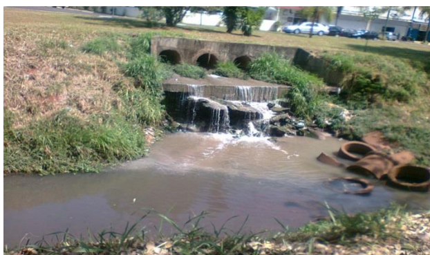
Figura 5: Lançamento de esgoto na rede pluvial, oriundo de vazamentos ou ligações irregular
