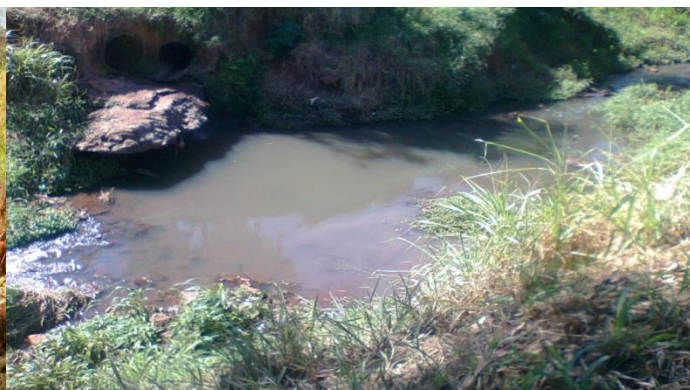
Figura 3: Presença de gordura visível sobre o espelho d' água.
