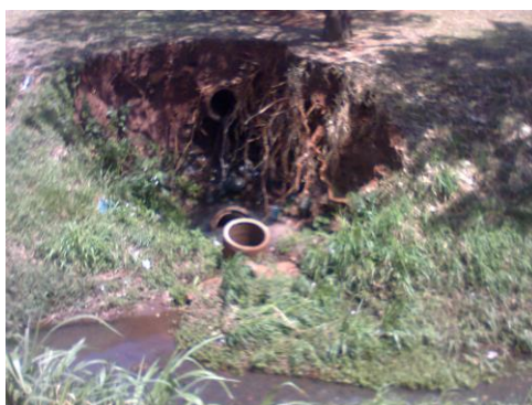
Figura 4: Erosão nos taludes e exposição das raízes das árvores da APP.
