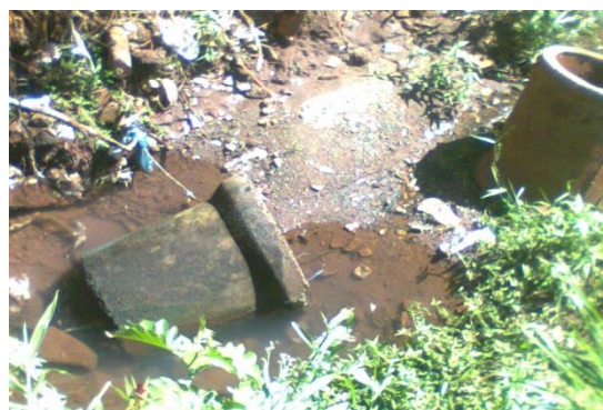
Figura 6: Tubos sob o leito do Córrego do Retiro Saudoso.
